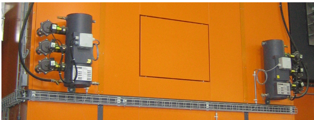
Fig. 7 Impianto di combustione con sistema automatico di pulizia della volta
