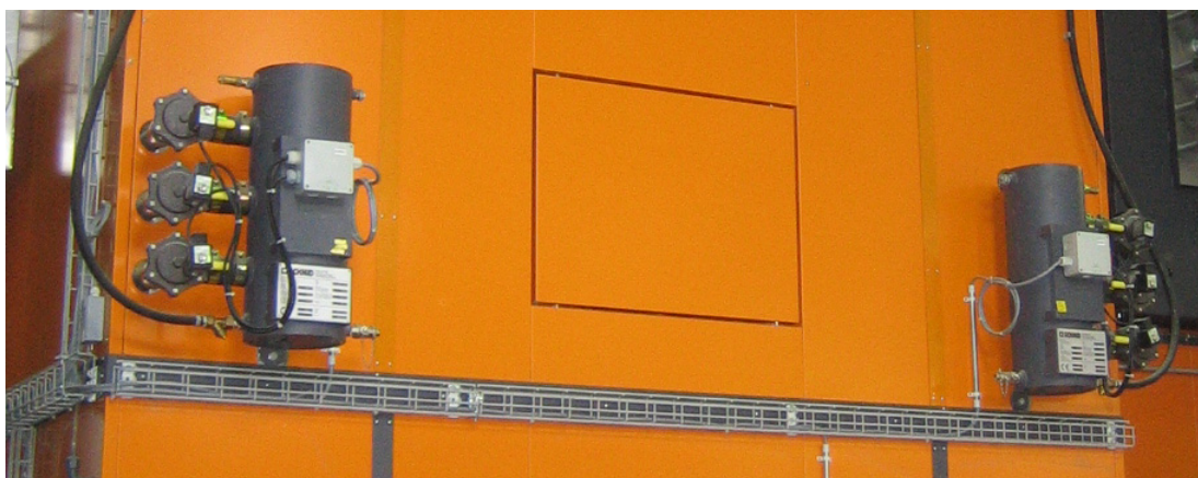
Fig. 8 Impianto di combustione con sistema automatico di pulizia della volta
