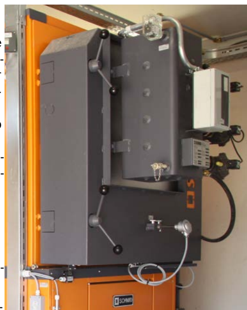
Fig. 6 Pulizia automatica dei tubi della caldaia
