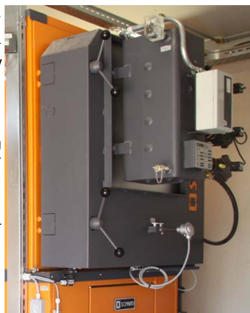
avb. 6 Automatisk rengjøring av kjelerør
